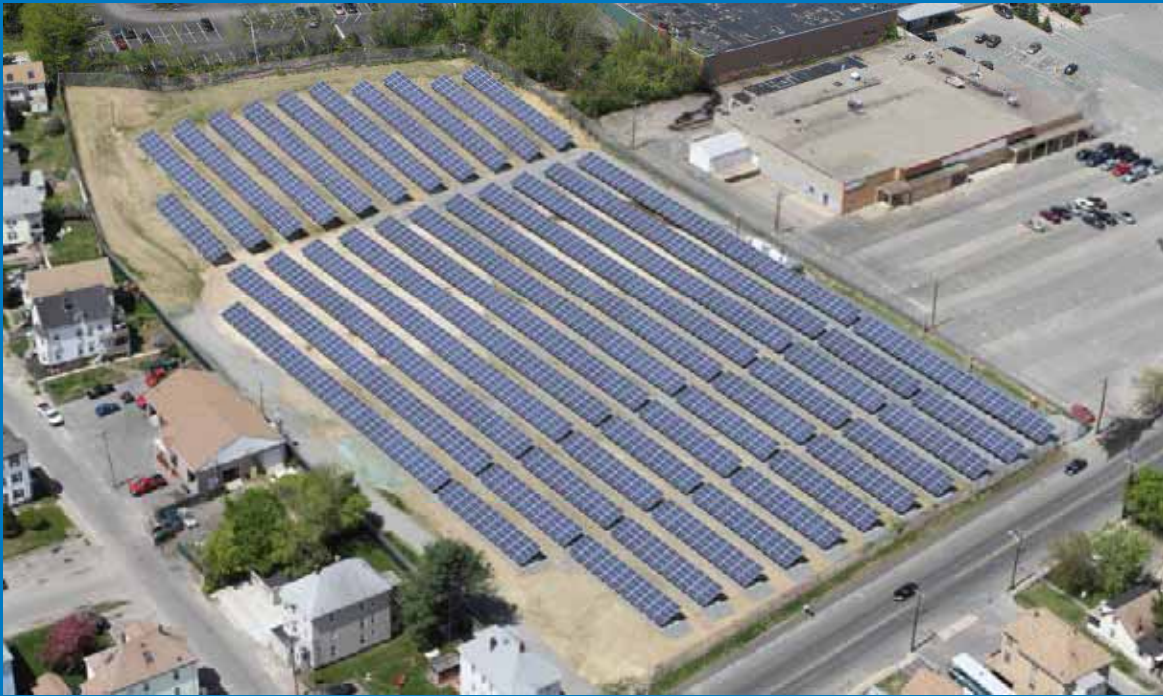
1 MW Haverhill, MA
