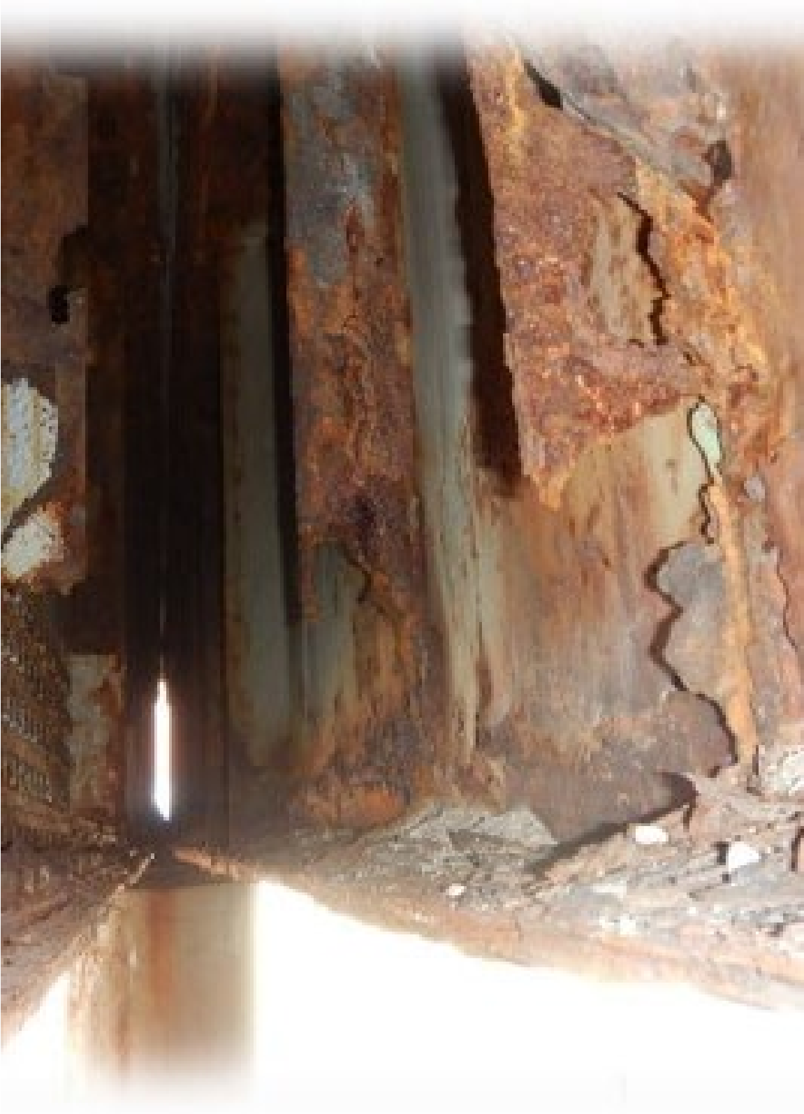
Deterioro Estructural - Superestructura de Acero
