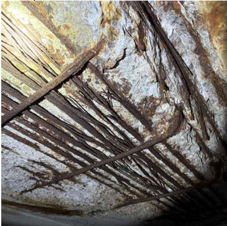
Fig 3: Travès bwat beton prekontraksyon ki deteryore gravman ki montre pèt siyifikatif beton ak kab prekontraksyon kase.
