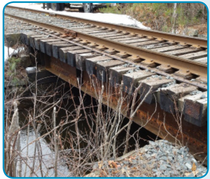
El puente Cotley River Bridge es uno de cuatro que serán reemplazados como parte de la acción temprana para el proyecto.
