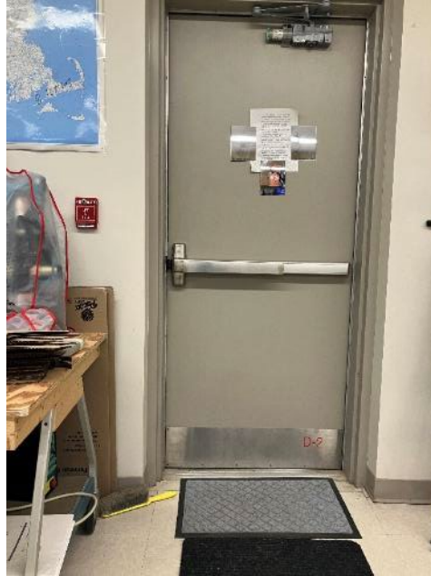
Gap beneath exterior door
